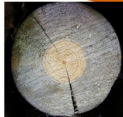
Sinizna drewna spowodowana przez grzyby
